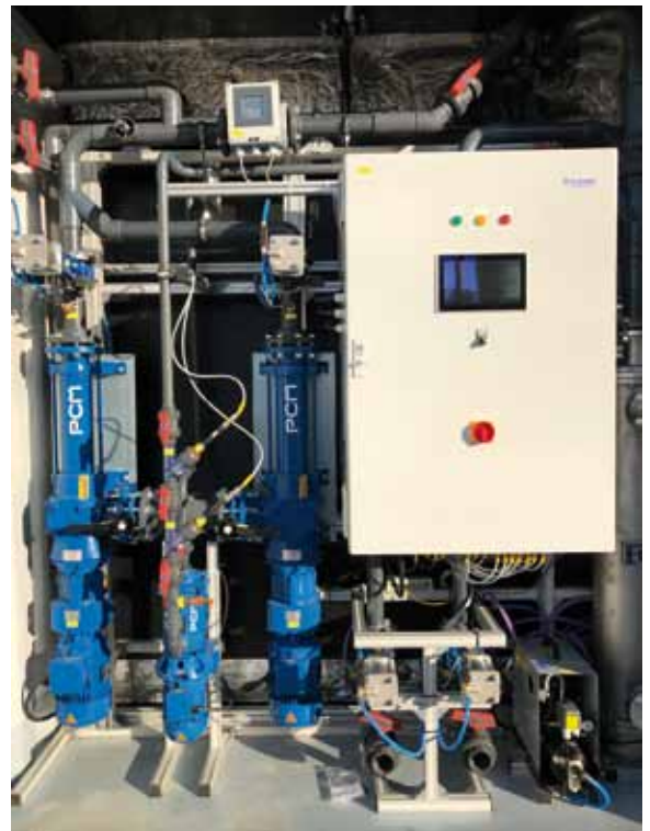
Technikraum einer anaeroben Abwasservorbehandlung
