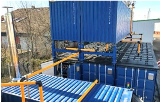
Abwasser aus Lebensmittelproduktion (Segeberg) ca. 430 m 3 /d (Indirekteinleitung), Anlagentyp AF-100
