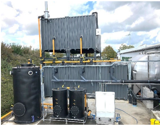
Abwasser aus Lebensmittelproduktion (Delbrück) ca. 200 m 3 /d (Indirekteinleitung)
